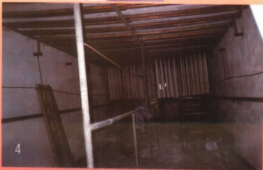
固定式隧道烘房
