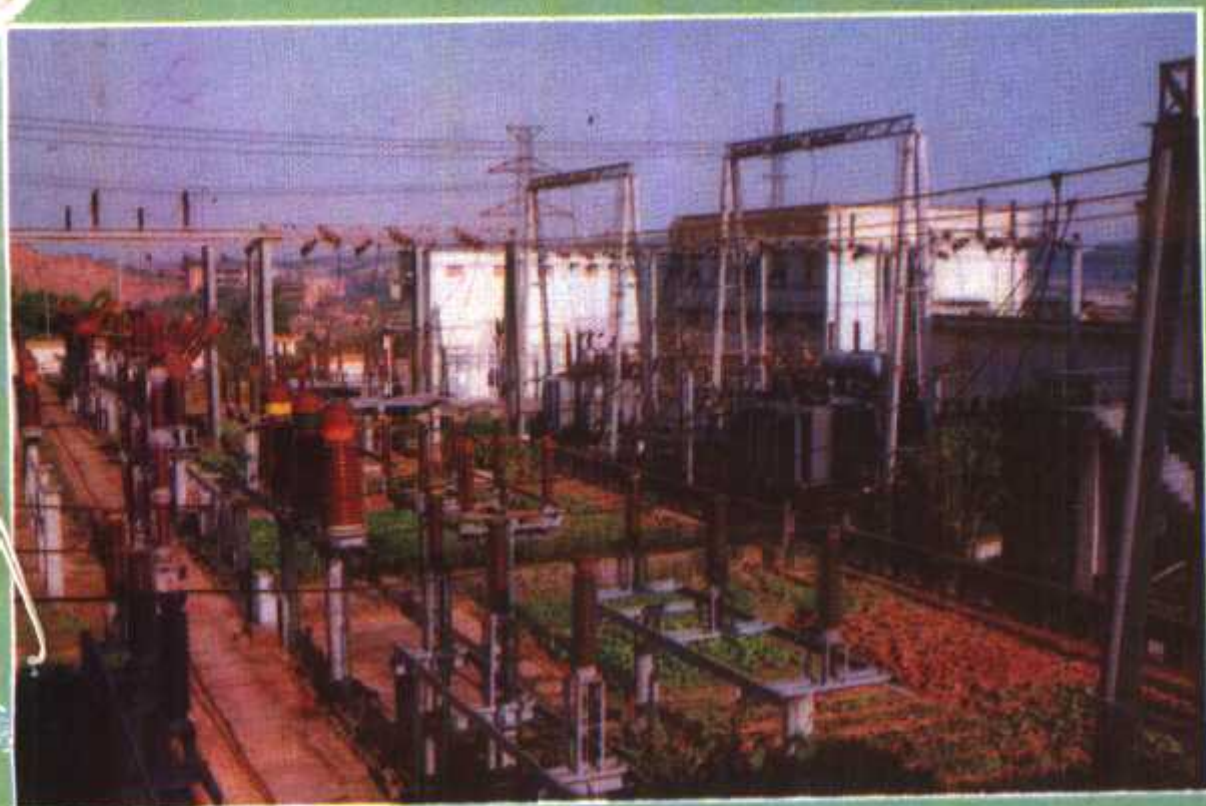
▲ 县城 110KVA 输变电站
