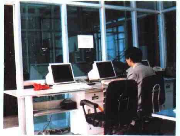
▲ 程控电话监控室 (梁志强 摄)
