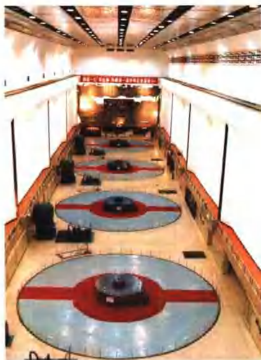
17 龙羊峡水电厂4×32万千瓦水轮发电机组
