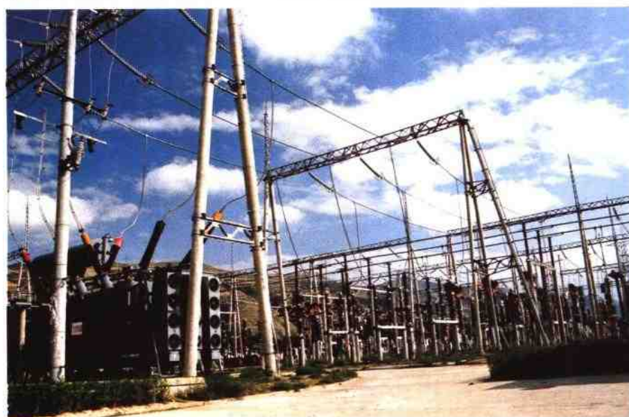
29 330千伏花园变电所 ( 2 \times 15 万千伏安)
