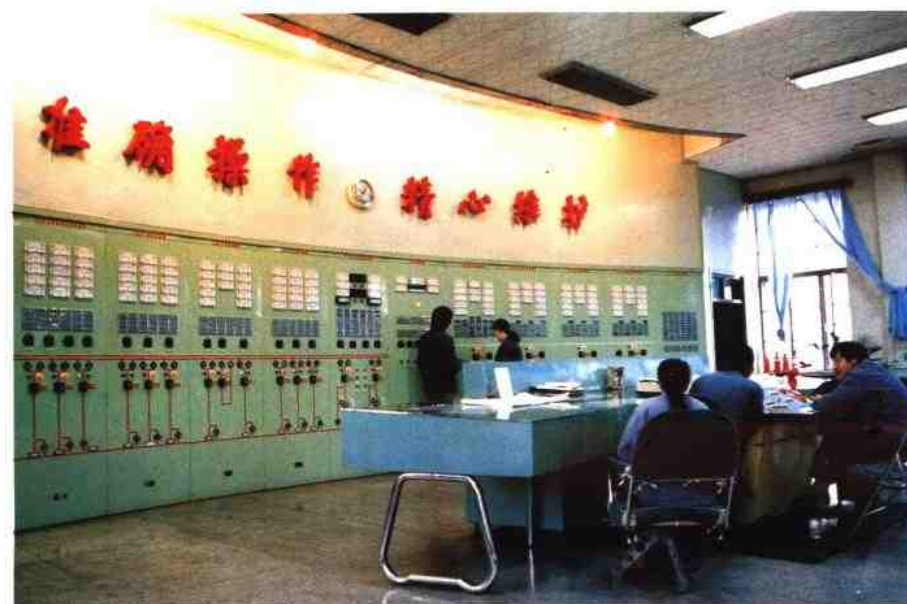
30 花园变电所主控室
