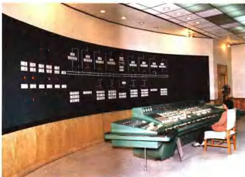
18 龙羊峡水电厂主控制室
