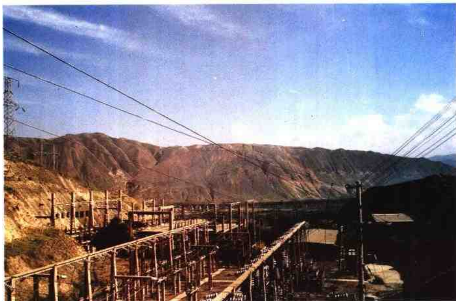
28 山沟里的110千伏变 电所—韵家口变电所 ( 2 \times 3.15 万千伏安)
