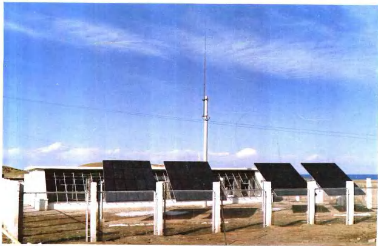
24 牧区太阳能光伏电站
