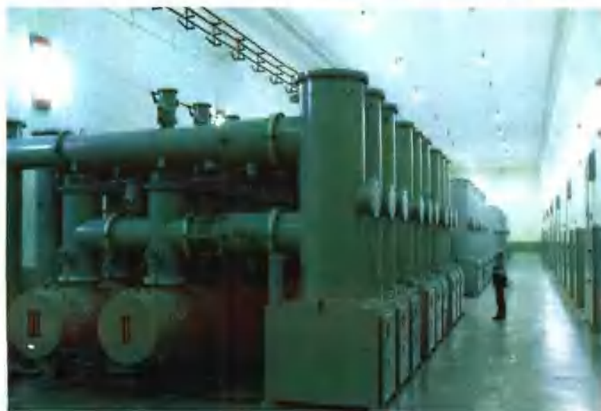
20 龙羊峡水电厂363千伏 六氟化硫全封闭组合 电器
