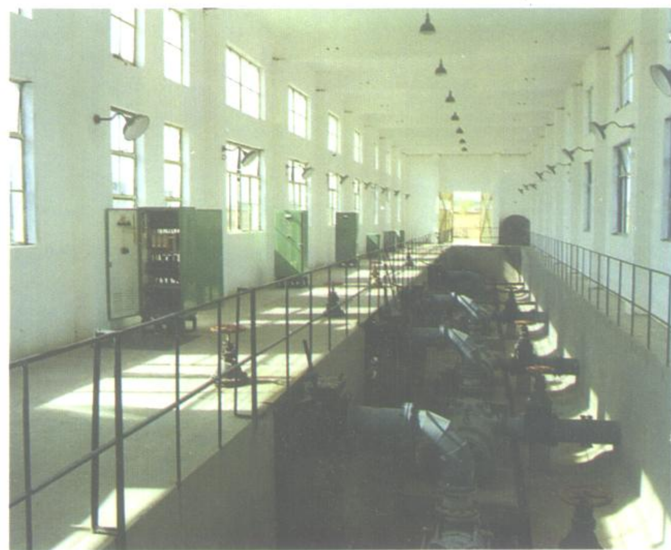
供水总站泵房
