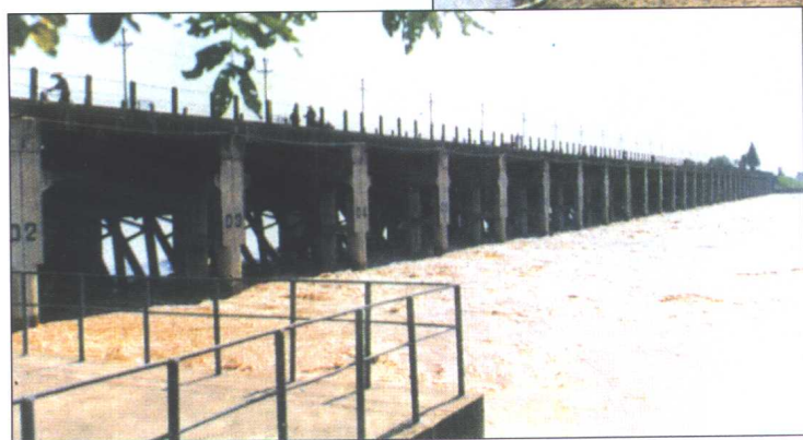
黄山头节制闸（南闸）
