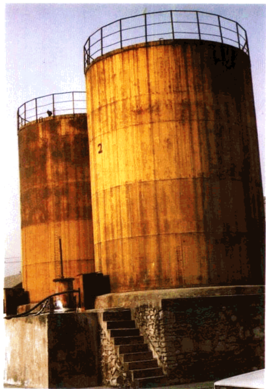
州物资局液碱库容罐
