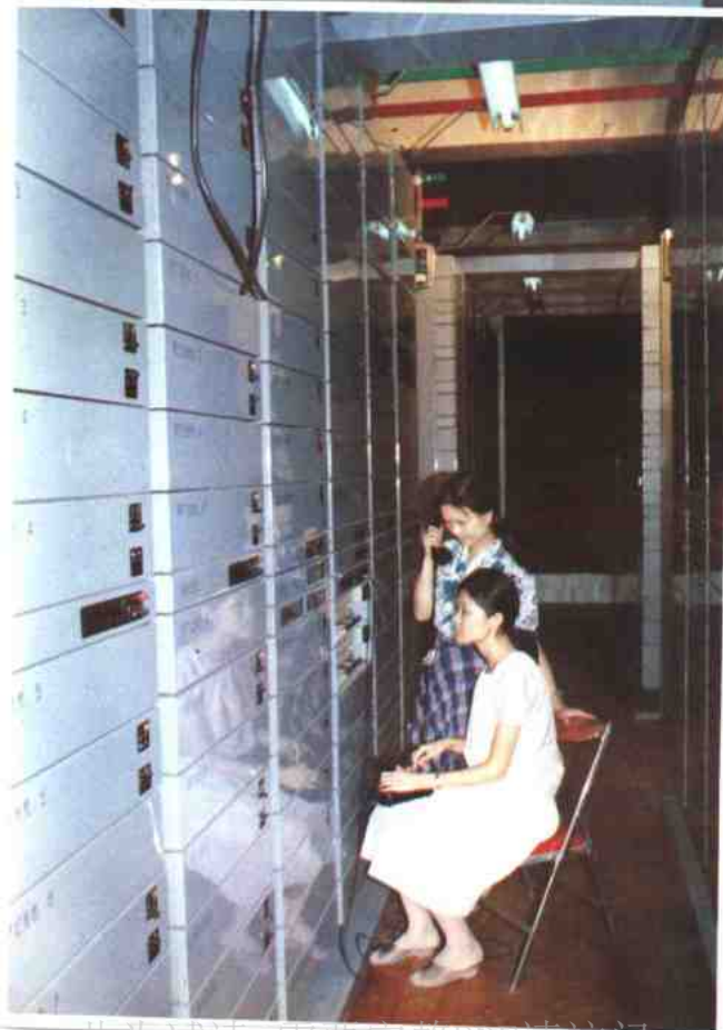
◀ 株洲市邮电局 80 年代的纵横制市内电话机房
