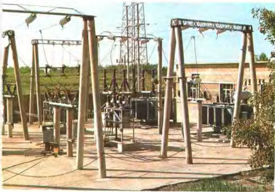
潮白新河引水专用 35 千伏变电站
