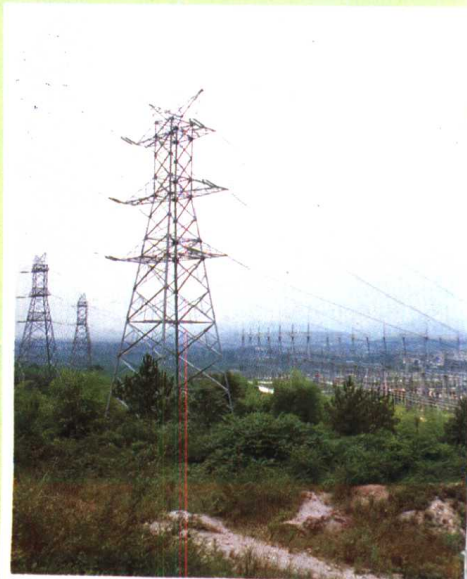
瓶窑500千伏變電所
