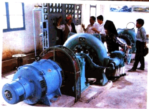
▲ 岩口彝族自治州响水河电站
