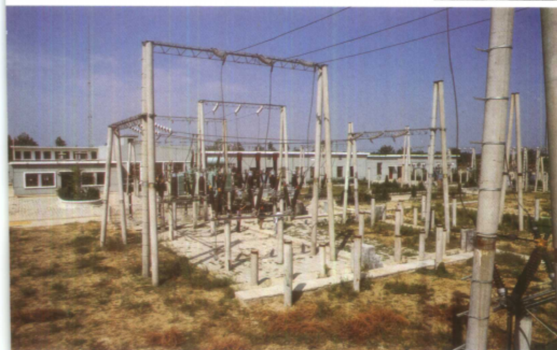
老南关变电站
