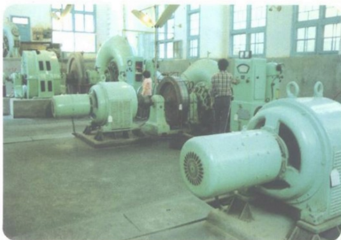
柯里电站机房
