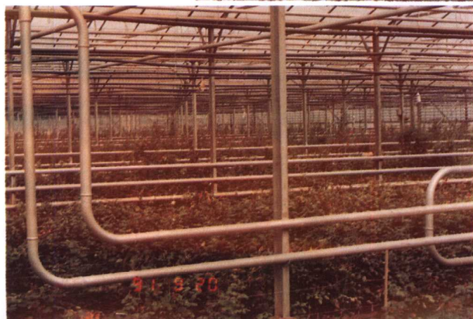
13. 中国农业科学院 蔬菜花卉研究所 玻璃温室热水供 热管道
