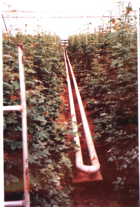
14. 北京中以示范 农场薄膜温室 热水供热管道
