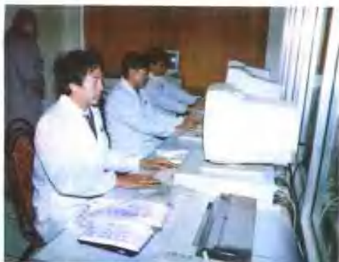
► 程控电话微机室
