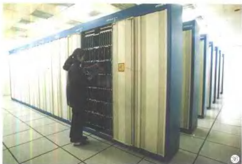
36. 江都县邮电局程控电话机 房
