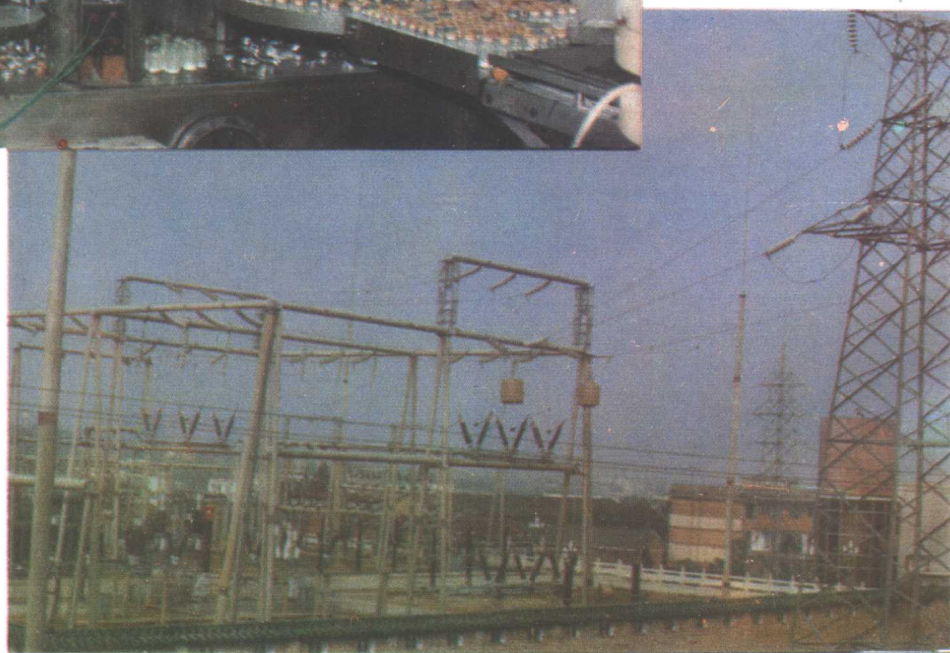
县城110千伏 ▷ 变电站
