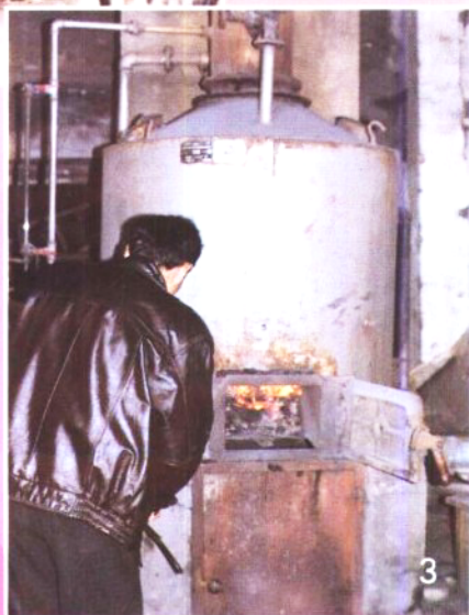
高压灭菌锅炉
