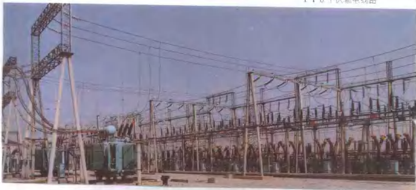
110千伏输电线路
