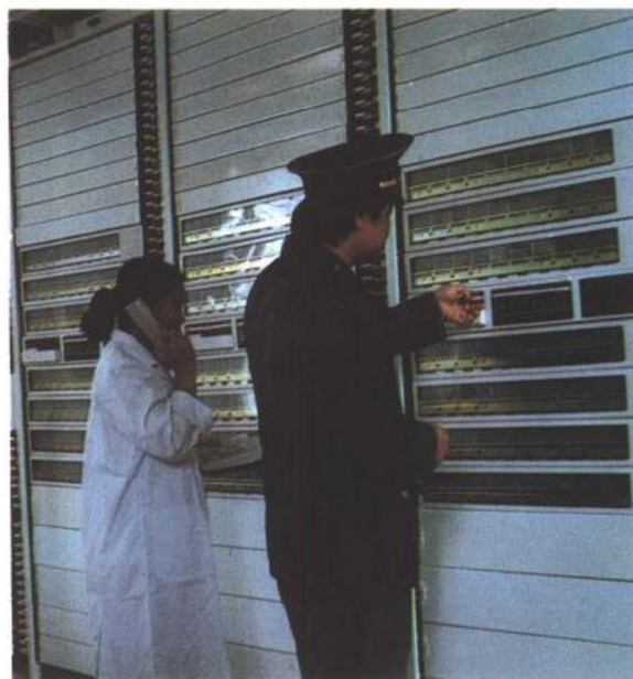
县邮电局自动交换机房
