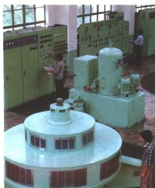
滑石板电站机房
