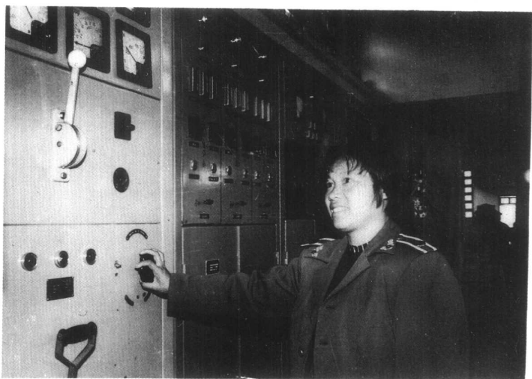
岑巩冲顶水电站供电房
