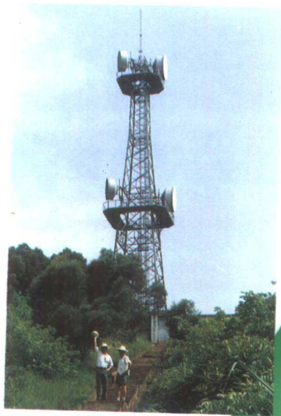
▲颜春岭微波塔
