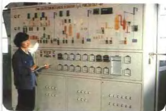
樟樹糧油公司精煉油控制操作屏
