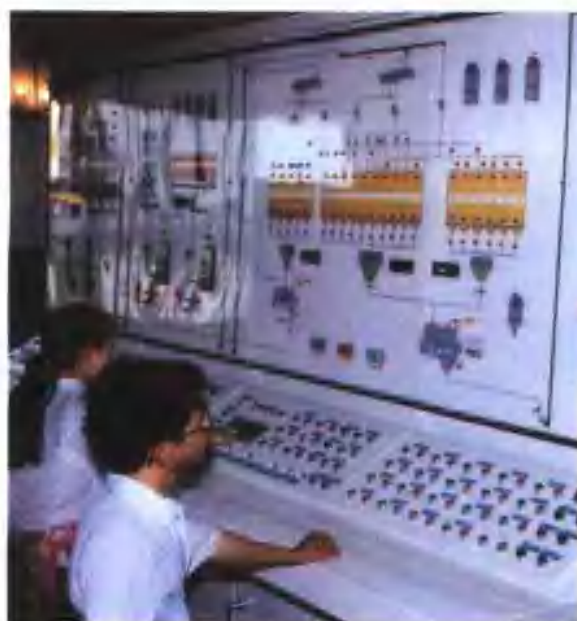
高安縣飼料廠中央控制室
