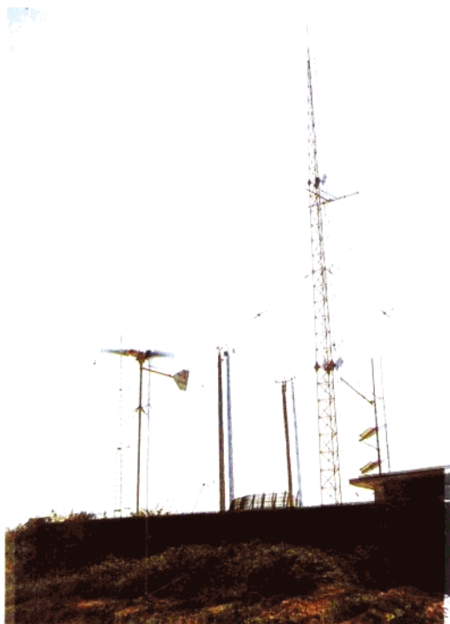
高山 DPC (无人气象站) 现场装置 ▶
