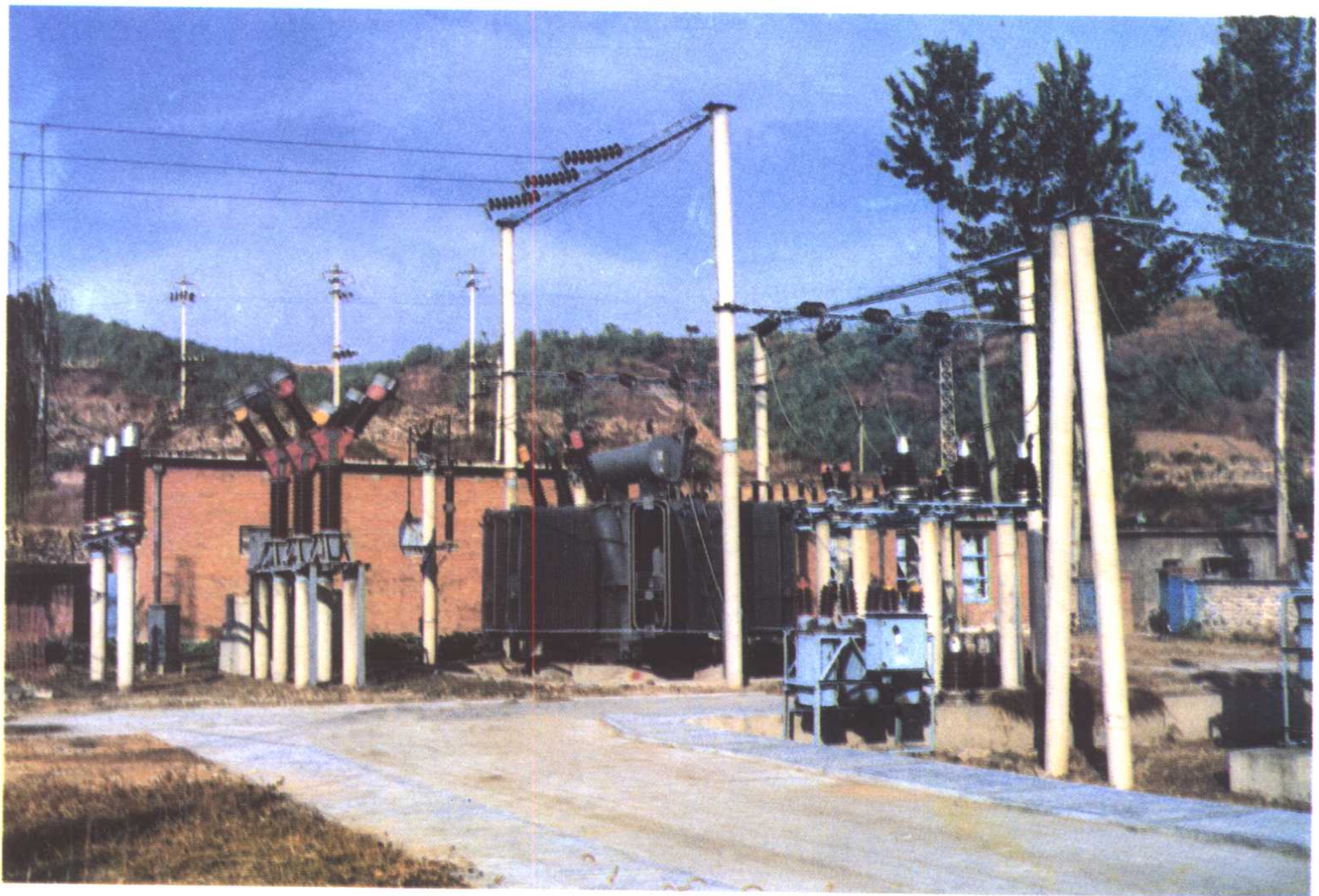
下：宽城变电站一角
