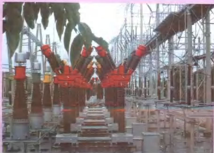
滇东电网最大的 220 千伏枢纽变电站——三岔 变电站
