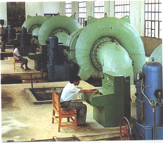
南荣田电站机房
