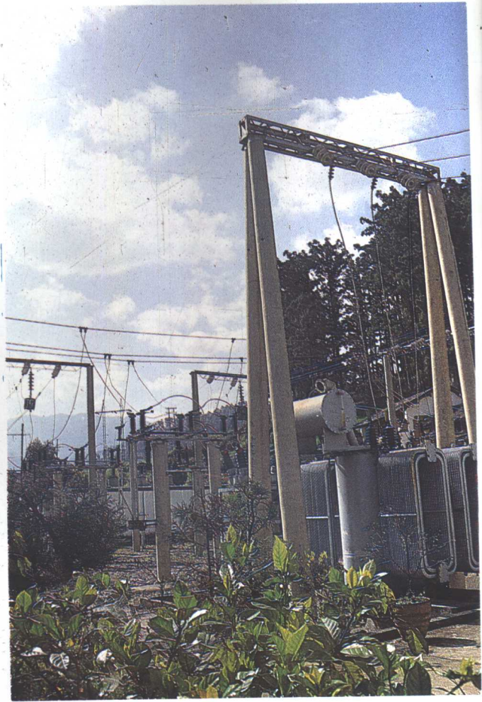
凤城中心变电站
