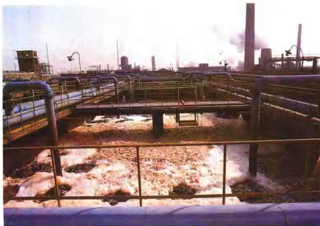
化工总厂南区生物脱酚工程
