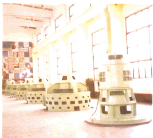
山东省引黄济青工程棘洪滩泵站内景
