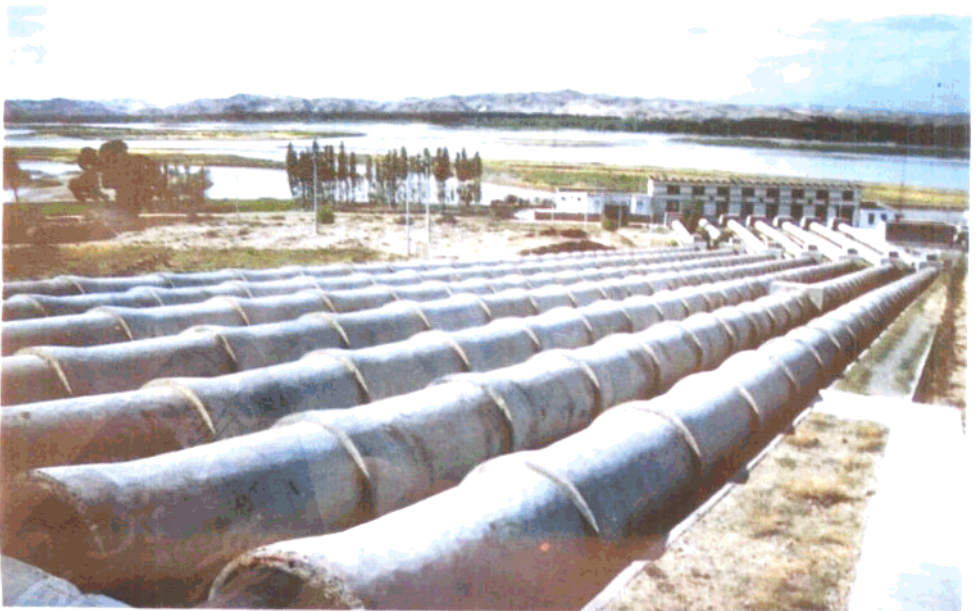
宁夏回族自治区固海泵站
