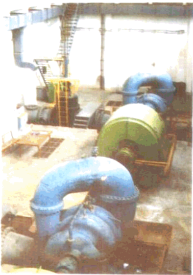
陕西省渭河一级泵站内部
