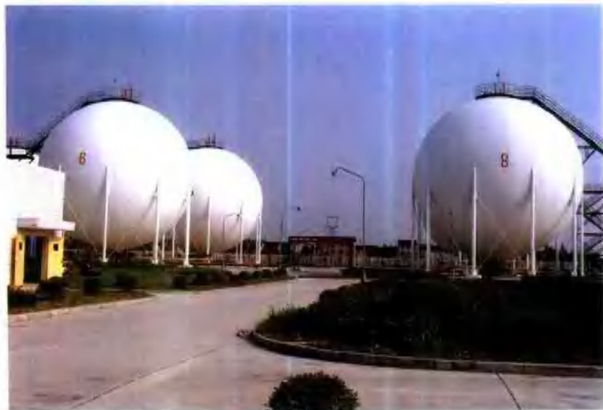
北祭天然气储配站 (潘建龙摄)
