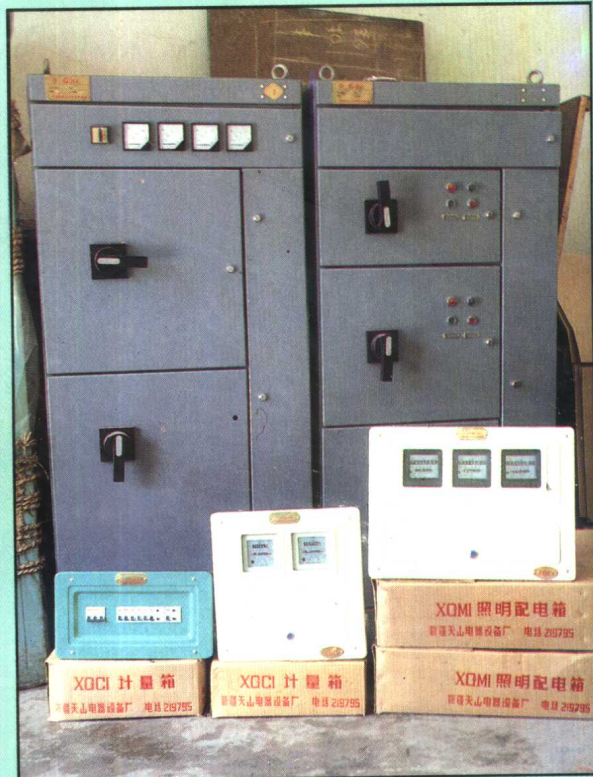
解放北路街道办事处天山电器设备厂生产的互感器、配电屏
