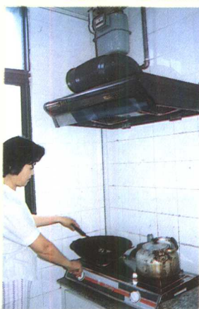
管道煤气用户
