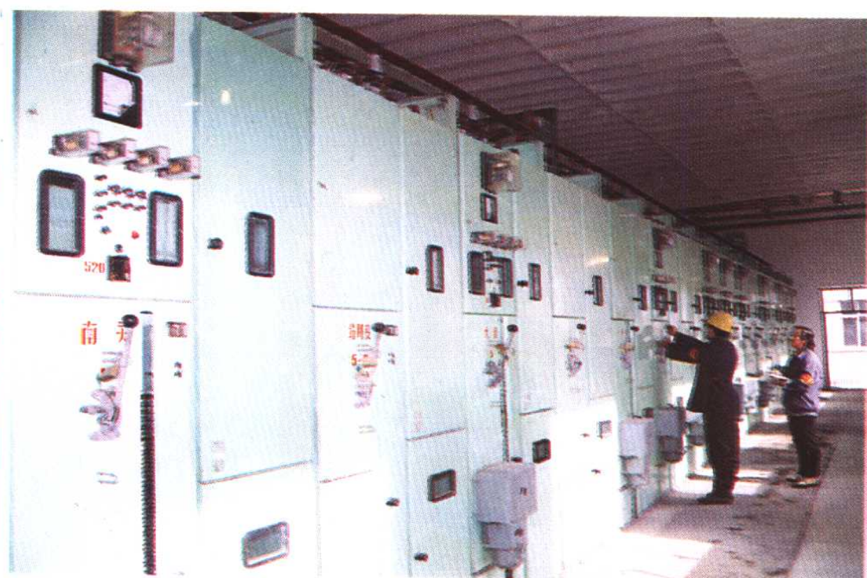
110 千伏变电站控制室
