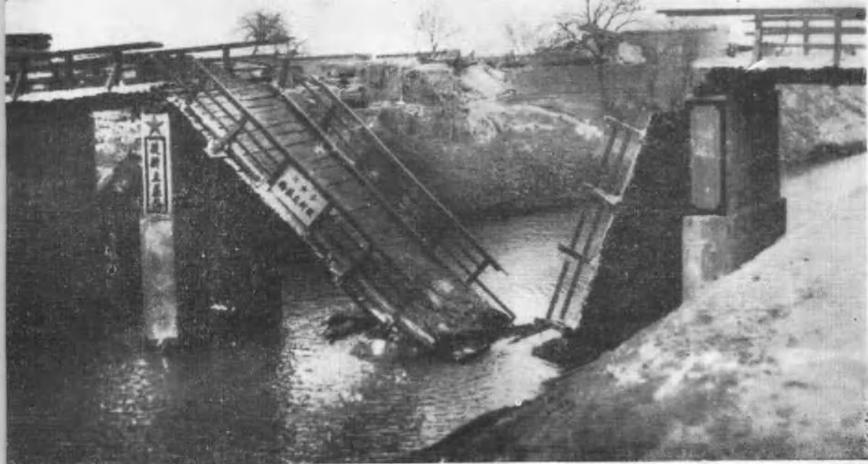
宁晋县耿庄桥公社后辛立庄滏阳河公路桥3月8日地震倒塌。
