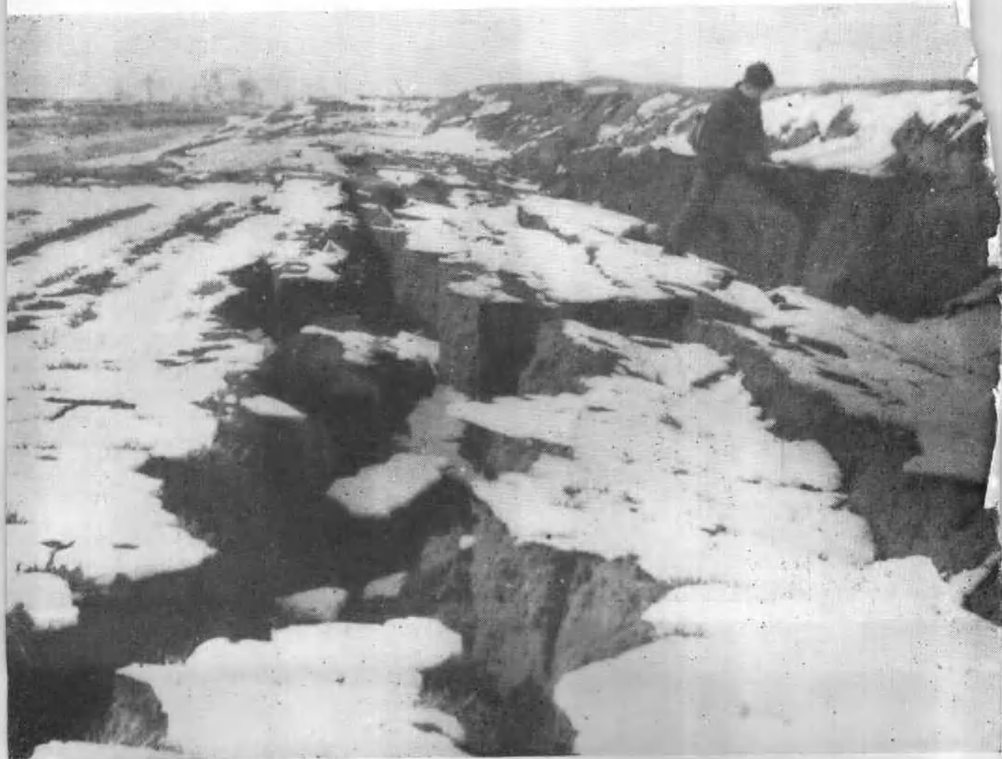
宁晋县耿庄桥公社滏阳河堤道路3月8日地震裂缝。
