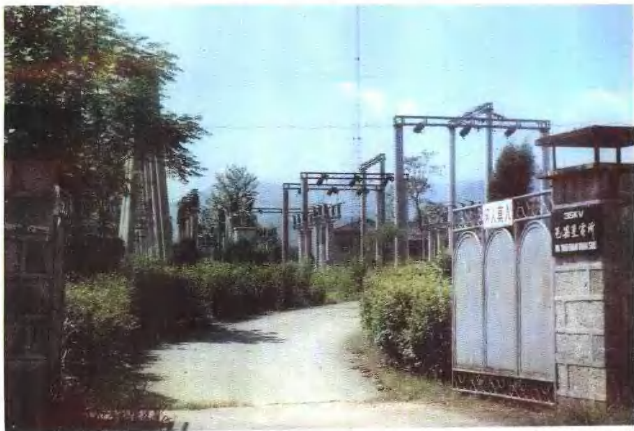
35 千伏瓦窑变电所。
