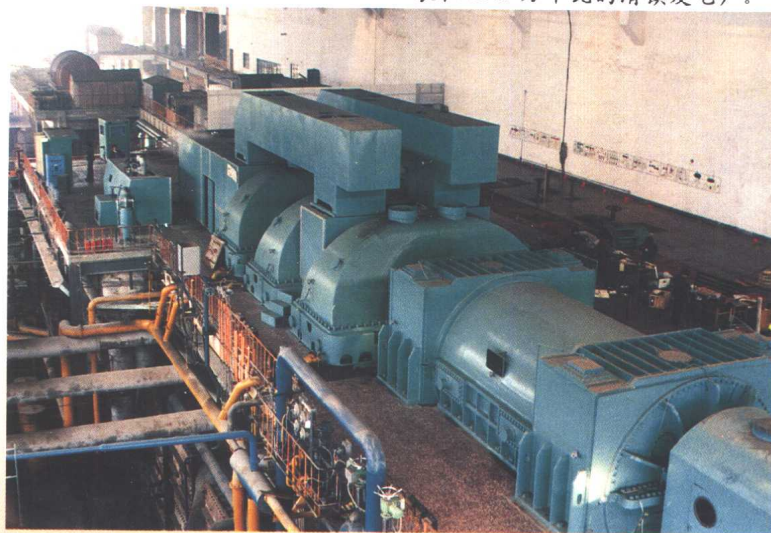
装机 65.8 万千瓦的清镇发电厂。
