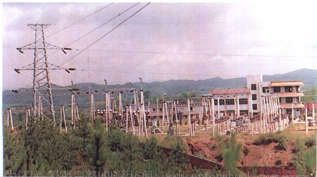
市供电局白泡变电站
