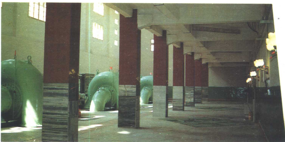
沙坪二级站机房
