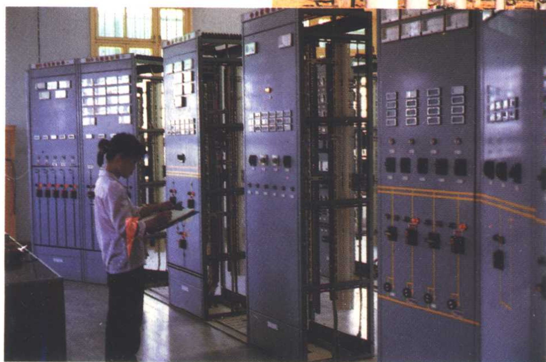
柳州~象州 110 千伏高压输变电站
