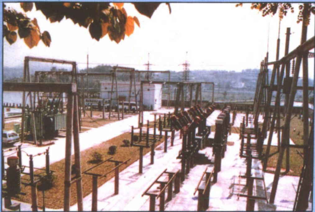
◀ 110 千伏输变电工程
