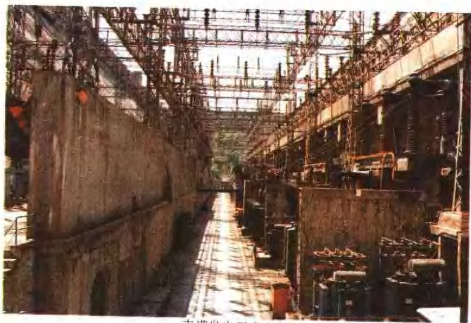
丰满发电厂变电所
