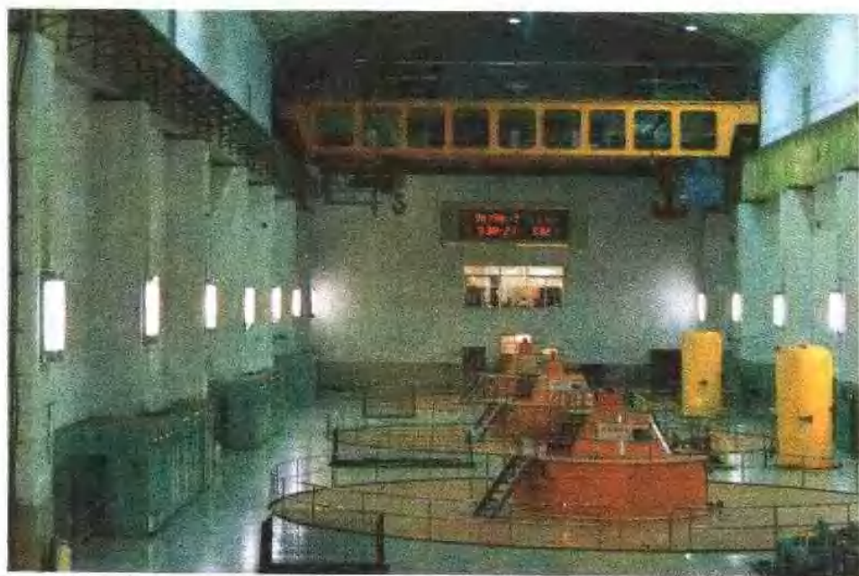
白山发电厂地下水电站发电厂房。
