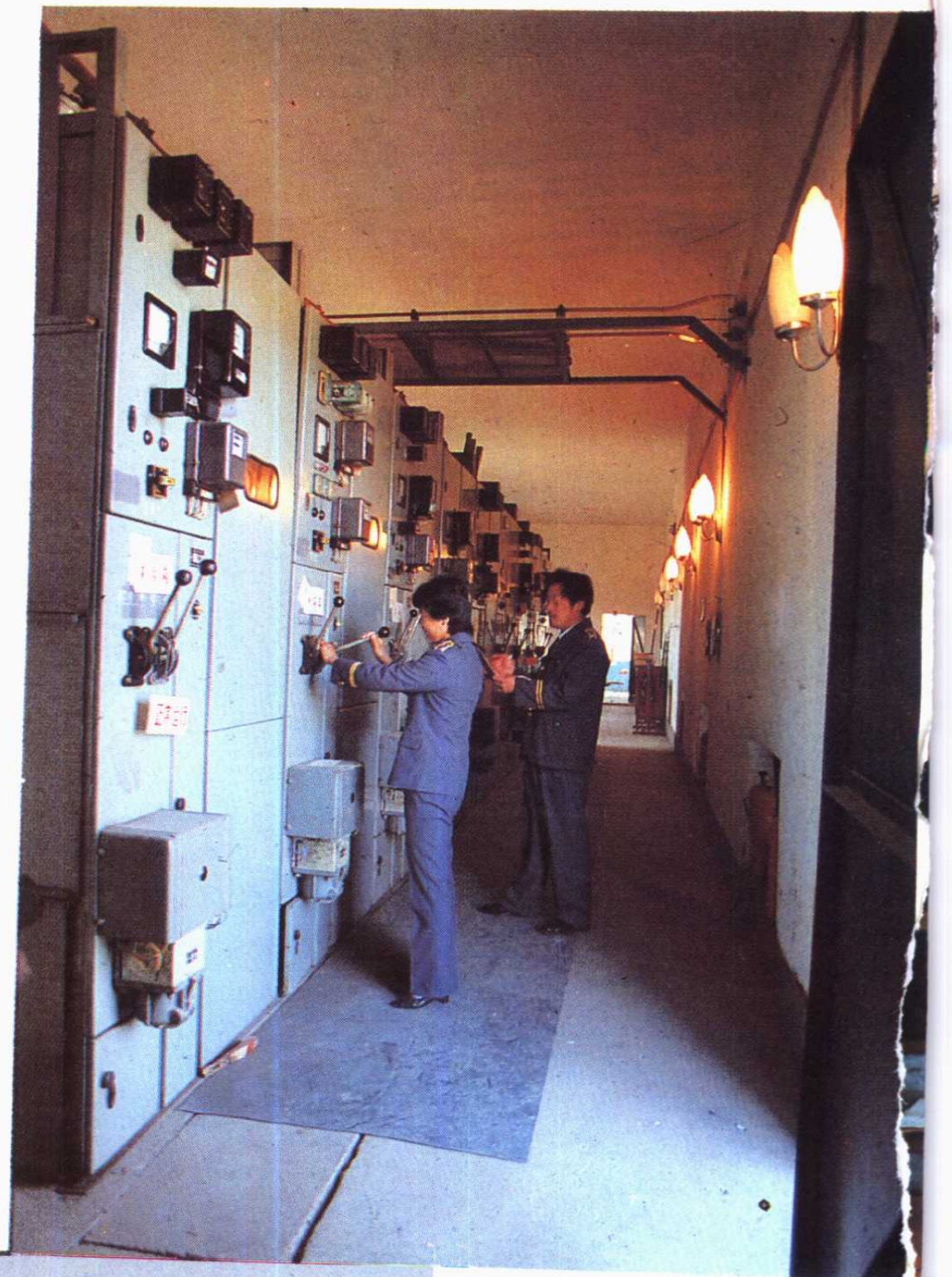
梁庄变电站机室
