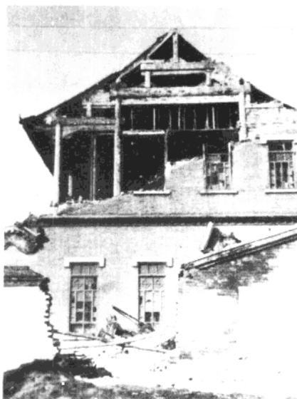
▲ 营口楞严寺藏经楼西山墙倒塌
