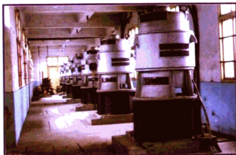
更新后的大浦闸排涝机组
