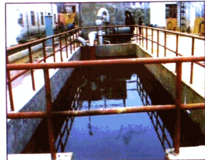
污水处理设施(3) 沉淀池
