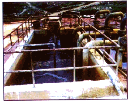
污水处理设施(1) 中和池
