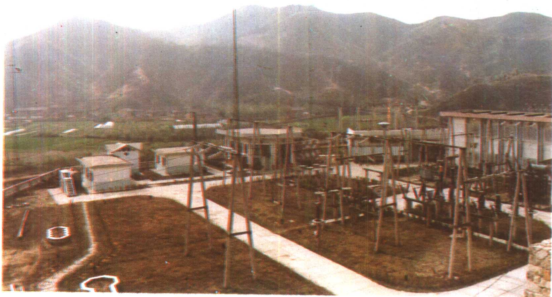
十一万伏变电站
