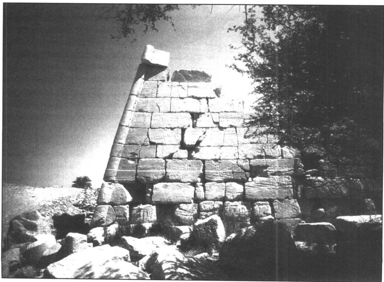
8. 拉美西斯陵庙第一院门楼的北塔,图中可以看到石块摇摇欲坠地悬在废墟顶上。
