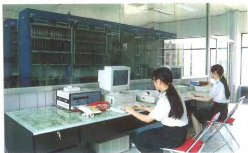
程控电话机房
