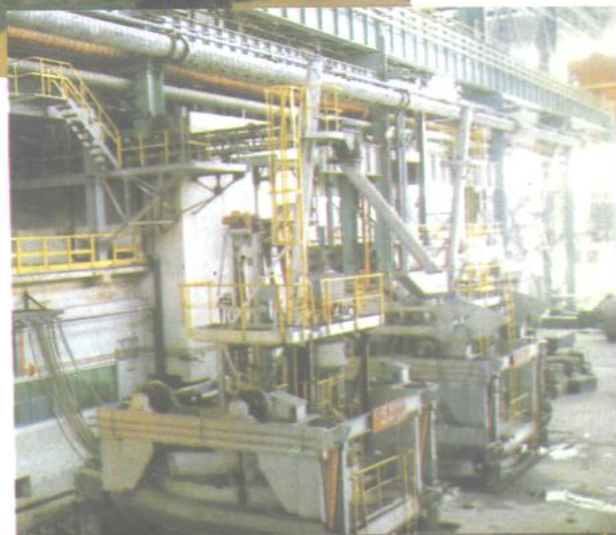
大冶钢厂60吨精炼炉
