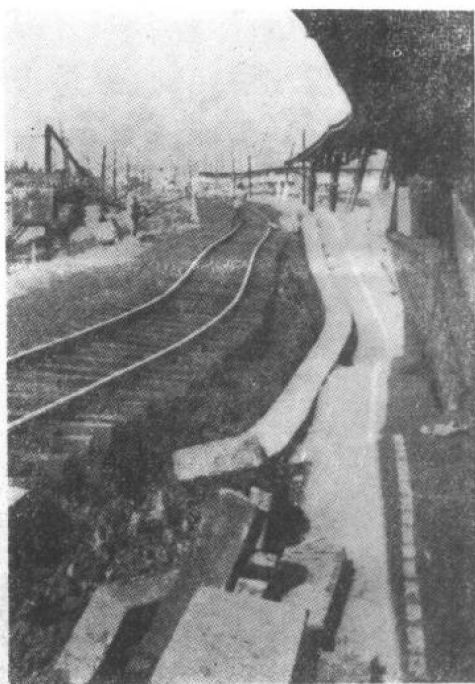
对轨道和站台的损害（新泻地震）
