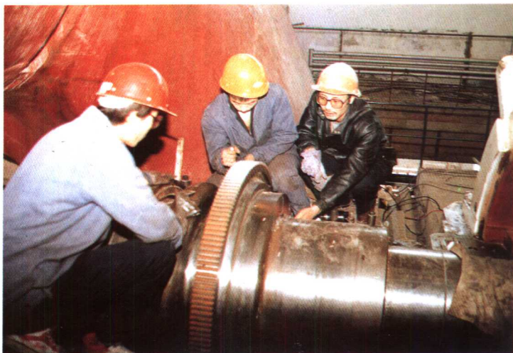
一丝不苟——检查新装机组运行状况
